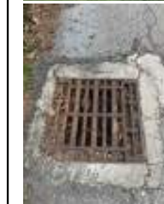
Ambito immediatamente a monte del sito in esame: si noti la scarpata di monte con elementi di rinforzo (muri e contrafforte) e lo stato di parziale occlusione della caditoia sotto griglia strada
